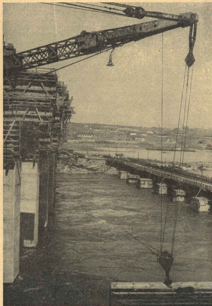
„Dnjeprostroi“, ein Gigant der sozialistischen Industrie Bau der Schleuse auf dem linken Ufer
